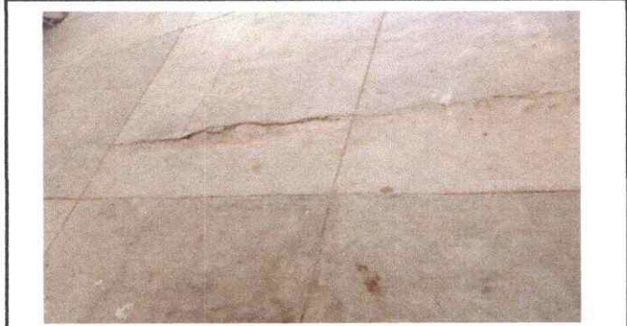
Foto 1: Piso interior en mal estado
