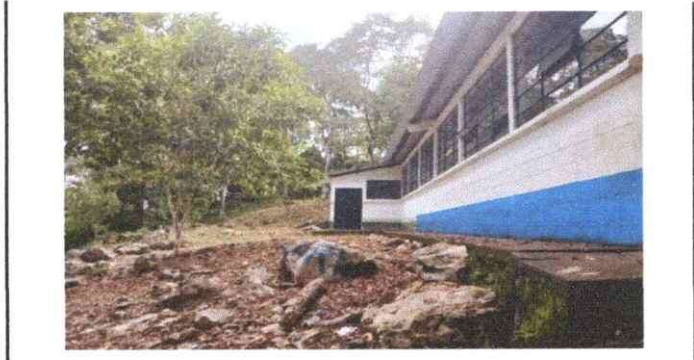
Foto 4: Corredor en mal estado
