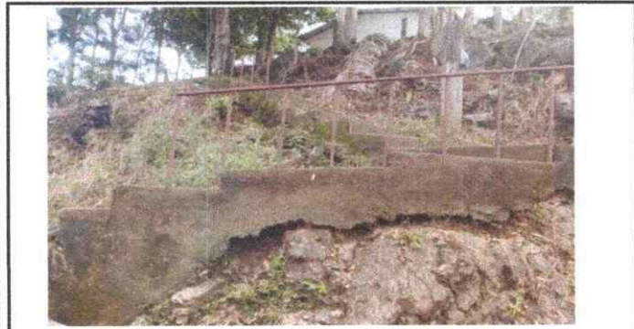
Foto 3: Barranda metalica de pasamanos en mal estado.
