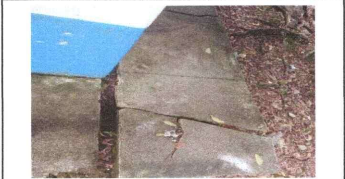
Foto 2: Piso exterior en mal estado
